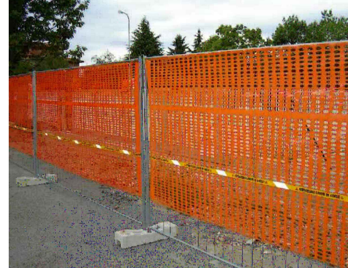
Esempio tipico di recinzione da cantiere
