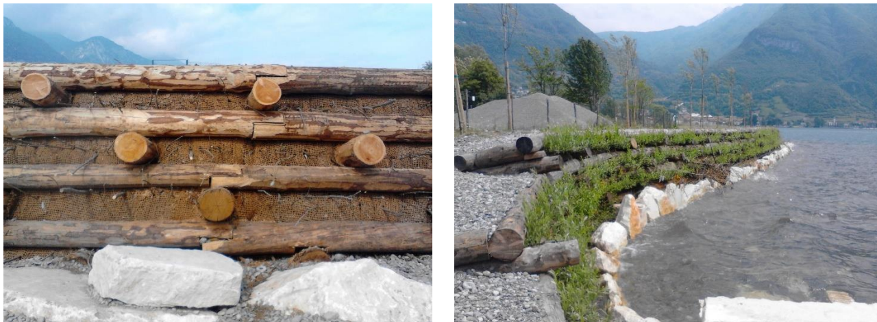
Figura 4.17 – Esempio realizzativo della palificata doppia: in fase di realizzazione (a sinistra) e opera ultimata (a destra)
